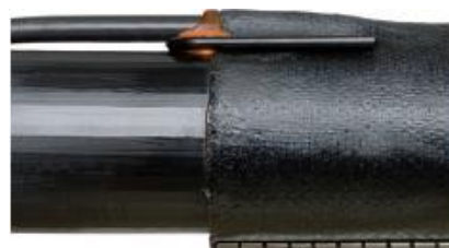
Prerušené prepojenie tienenia pre transpozíciu
