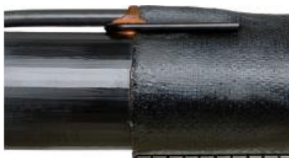
Prerušené prepojenie tienenia pre transpozíciu
